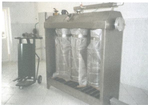
Zdjęcie 6. Oczyszczalnia ścieków w Kobielach Małych. Workownica do osadu DRAIMAD.
